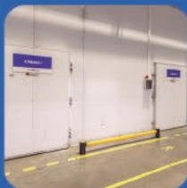
Cámaras de frío
